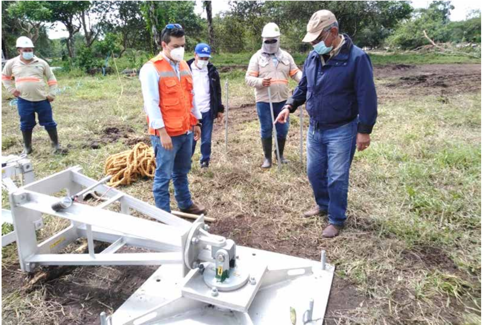
Carlos Mosquera, gerente de ETESA, realiza una inspección de daños ocasionados en el sistema de transmisión.
