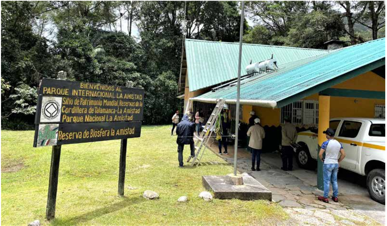
Instalación de calentador solar de agua donado a la residencia de guardabosques en el Parque Internacional La Amistad, área protegida transfronteriza gestionada por Panamá y Costa Rica.
